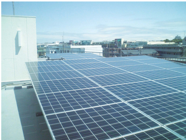
◀大府本社 社屋に設置された太陽光パネル
